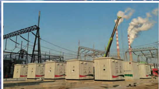
江苏常熟电厂储能项目
